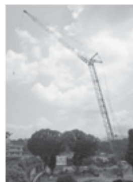
120tのクローラータワークレーンを設置し、工事を進めています。
